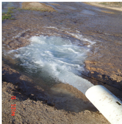
Fotografía 16 Descargas de los pozos bombeo
